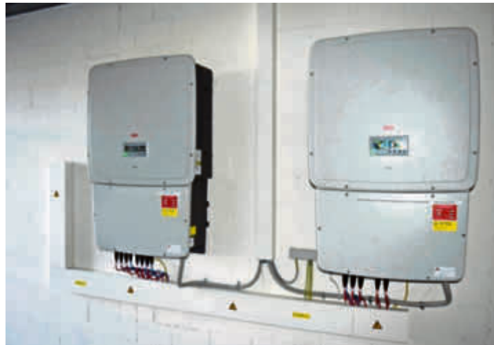
Mit dieser Wechselrichteranlage wird der Gleichstrom aus den Solarpanels in Wechselspannung umgewandelt und in das Stromnetz des Betriebs eingespeist.
